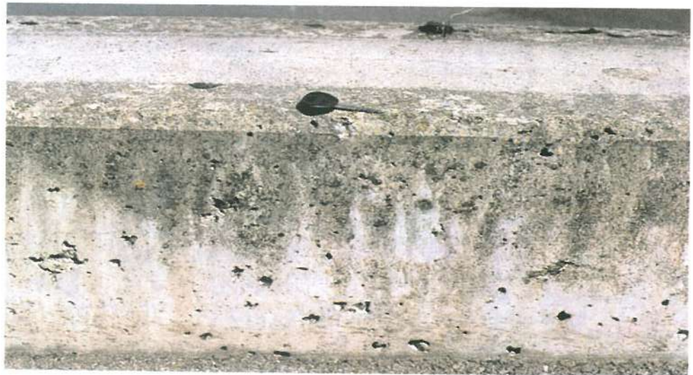
تصویر ۳- منافذ بزرگ در قسمت سطحی بتن
